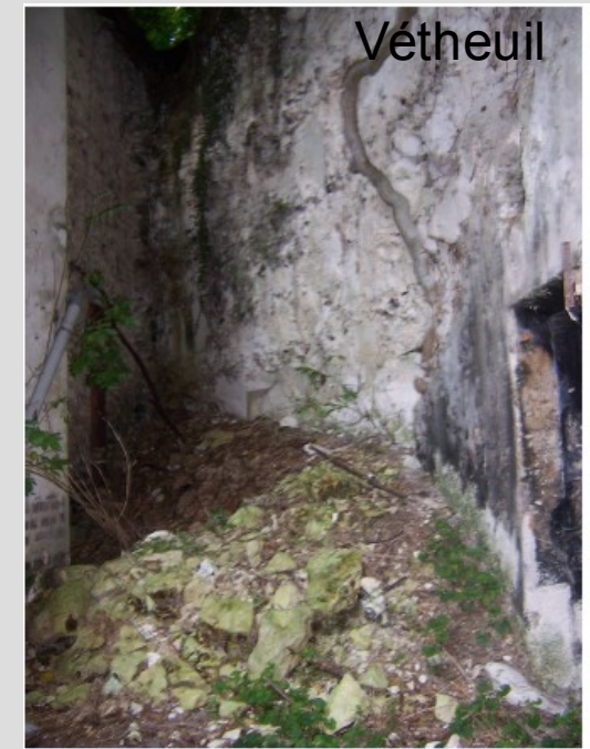
Photo 7 – Ancien éboulement de front de falaise - avenue Claude Monet
